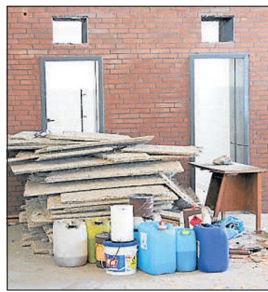
Vor den Umkleidekabinen stapelt sich Schutt, der entsorgt werden muss.
