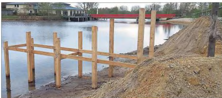
Umzug: Der Treibbootsteg am Obersee wird zurzeit auf die gegenüberliegende Uferseite verlegt. Dadurch erhofft man sich eine höhere Nachfrage. Bilder: Vredenburg
